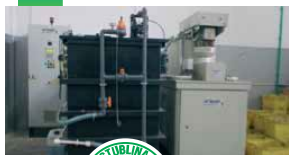
Prečišćavanje vode Water Purification Перечистка воды
